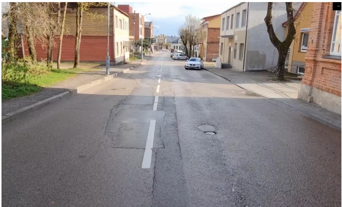
Pav. 3. Išdinės gatvės techninė būklė
