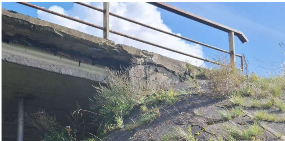
8 pav. Ramtų paviršius sutrūkinėjęs.
